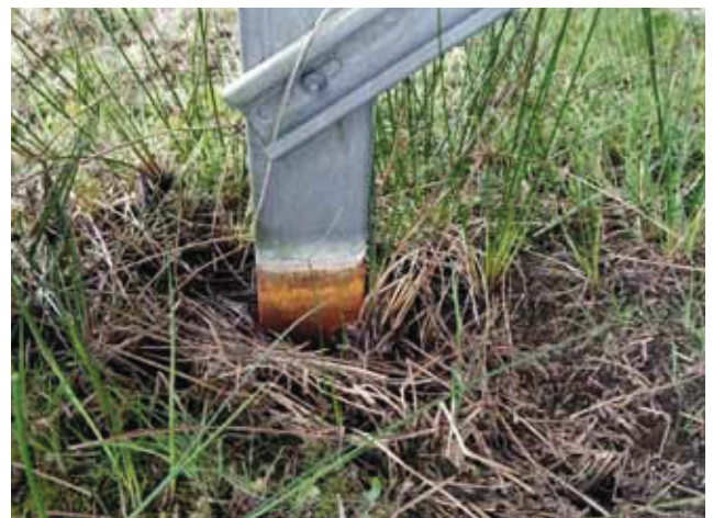
Dieser Rost am Stahlpfosten beruht auf einem Konstruktionsfehler.
